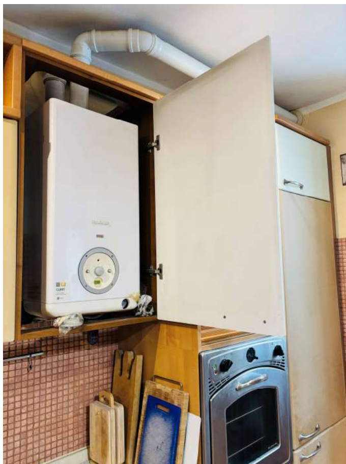
Fotografia 17. Piano Terra. Cucina. Particolare caldaia.
